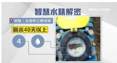
圖 2：智慧水表疑似漏水提示 (資料來源：賴碧香、李世泓(2017))
